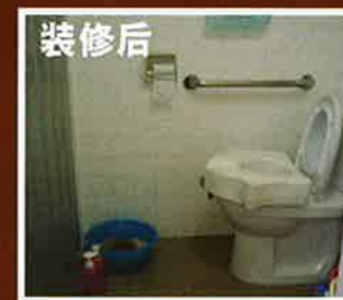
装修后 改装坐式马桶，另外安装马桶升高垫和手把，并进行抗滑地板处理
